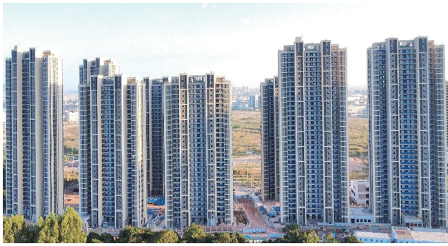
▲位于同安区同翔高新技术产业基地的龙泉公寓二期项目,正在进行精装修工程施工。
