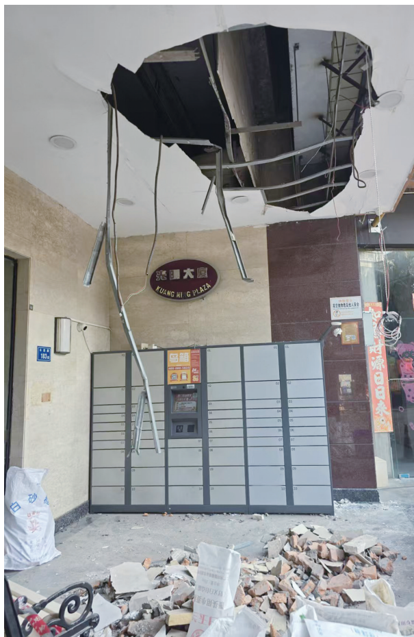
▲大厦门口吊顶被砸穿现场。
