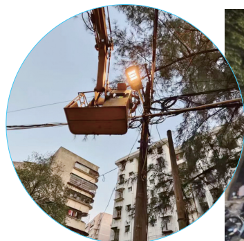
古塘路路灯采用寄杆安装的方式。
