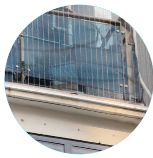
▲一住户加装外凸式防盗窗的墙体产生了长长的裂缝。
