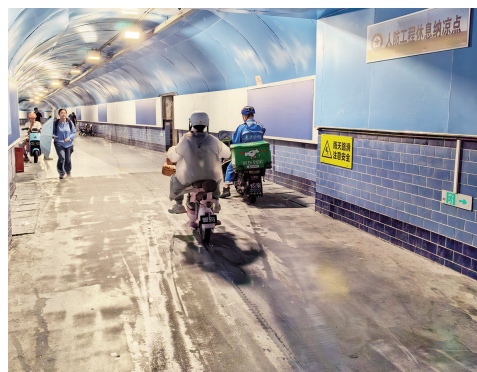
▲整改前,一遇雨天通道内满是水渍,容易滑倒。
