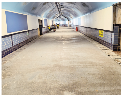
▲整改后,通道地面明显粗糙,隐患消除。
