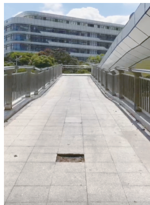
▲人行天桥坡道上一地砖缺失。海峡拍客 代岩/摄
