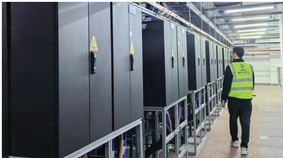
厦门移动南数机房。
